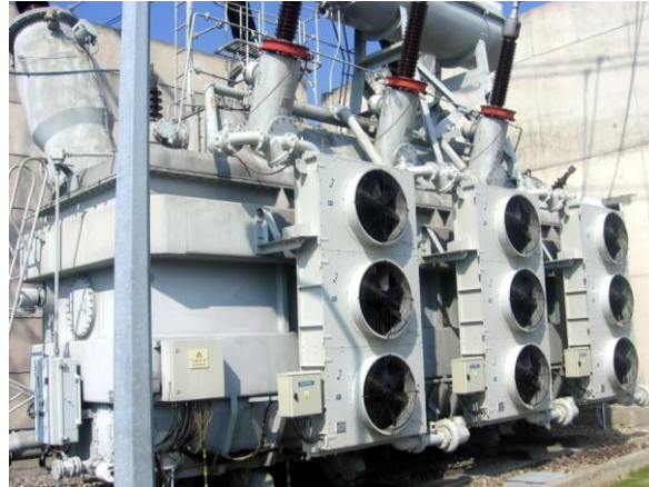
Rys. 2. Chodnice olejowo-powietrzne o mocy 325 kW na transformatorze typu AISR30-330000/400PN
