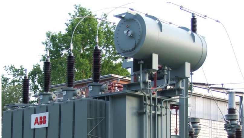
Rys. 4. Konserwator dwukomorowy zainstalowany nad kadzią transformatora
