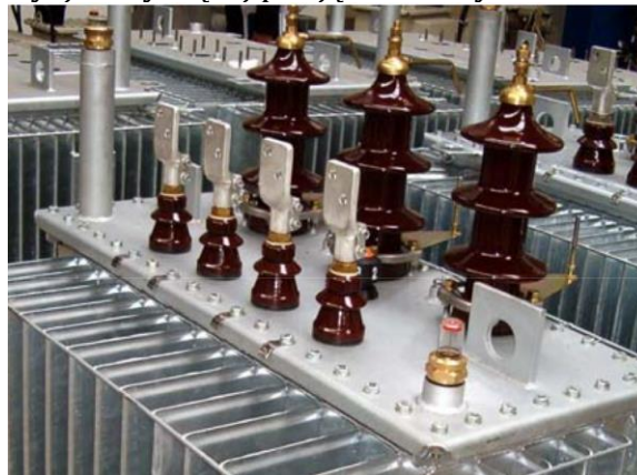
Rys. 3. Izolatory przepustowe zainstalowane na transformatorze rozdzielczym olejowym trójfazowym
